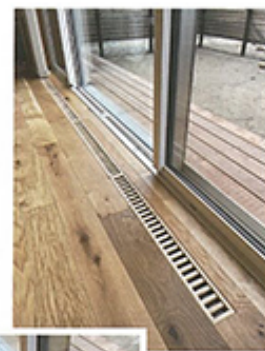
LDKなど1階メインルームの床に設ける給気口。床下空間が正圧に保たれるためほこりが落ちにくい
