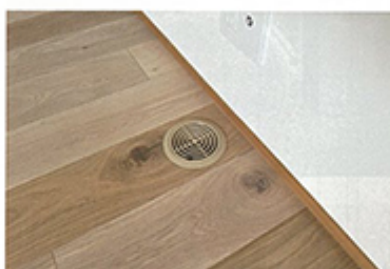
居室の床に設けた排気口。居室排気の仕組みも体感の向上に寄与すると評価している
